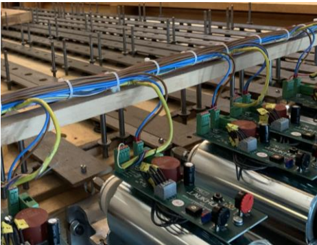
Neuen Schleifenzugmotoren samt Schleifen im Schwellwerk Foto: J. Kiene
